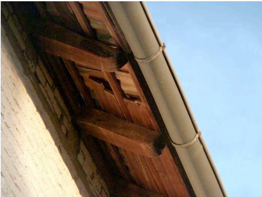
Abb. 2: Traufbereich des Mühlengebäudes, Spalten und Hohlräume über dem Bauerwerk bzw. unter der Holzverkleidung mit Niststätten von Mauersegler und Haussperling; potenzielle Standorte für Fledermausquartiere
